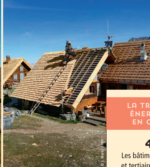
À gauche, refuge du col du Palet et cabanon abritant la pile à hydrogène permettant l'autonomie énergétique (Peisey-Nancroix). À droite, chantier de réfection des toitures en tavaillons (isolation et couverture) et création de WC secs au refuge de la Valette (Pralognan-la-Vanoise).
